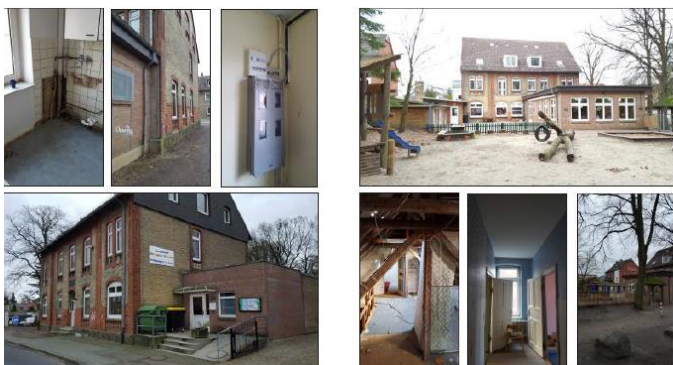
Die Fotos zeigen das stark sanierungsbedürftige Gebäude.
